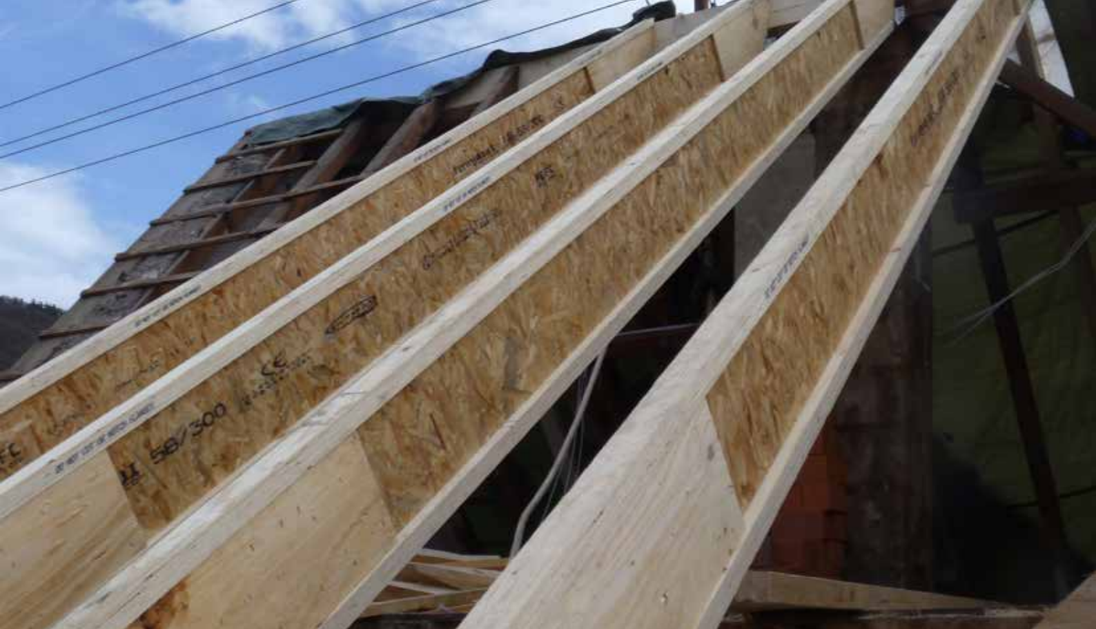
Die Zimmerei Grüber hat das Dach eines Einfamilienhauses in Schriesheim energetisch auf Vordermann gebracht und mit einer Gaube erweitert.
