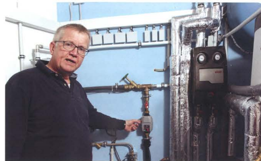
Bauherr Rolf-Stefan Scheible zeigt den Technikraum, wo PV-Strom und Zisternenwasser kontrolliert werden.
